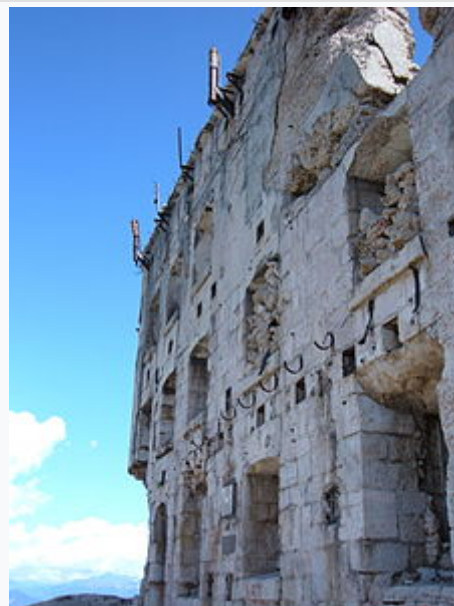
Rovine della facciata nord del forte Vezzena
